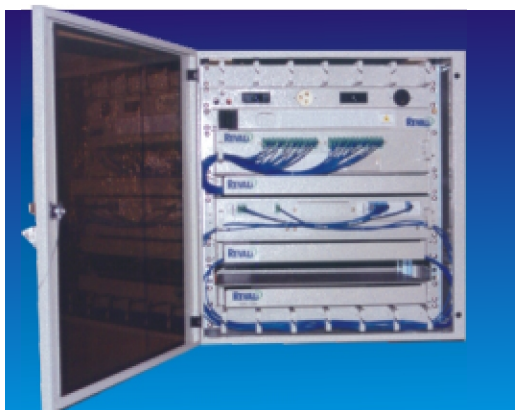
VISTA FRONTAL COM VÁRIOS TIPOS DE EQUIPAMENTOS INSTALADOS
