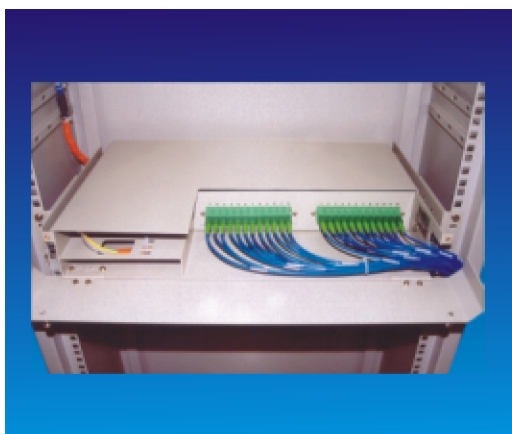
VISTA FRONTAL DO STOH-75021 COM ADAPTADORES E CORDÕES INSTALADOS
