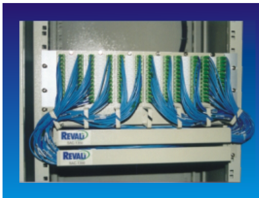
VISTA DO STOV-4300 144 FIBRAS INSTALADO COM ADAPTADORES, CORDÕES E 2 GAVETAS SAC-1300
